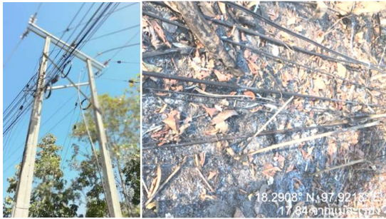
รูปที่ 14 สายฯ เส้นทาง “แม่สะเรียง-แม่ลาน้อย” ที่โคนไฟไหม้จุดแรก
