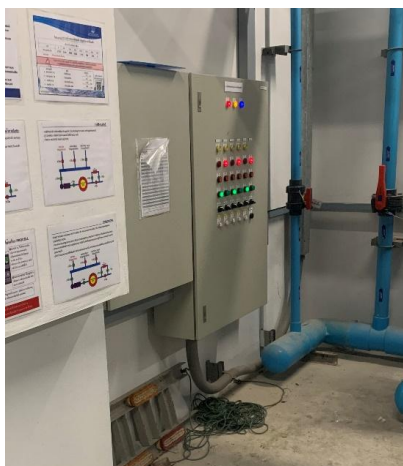
ภาพที่ 4 แสดงตู้ควบคุมระบบไฟในสระ
